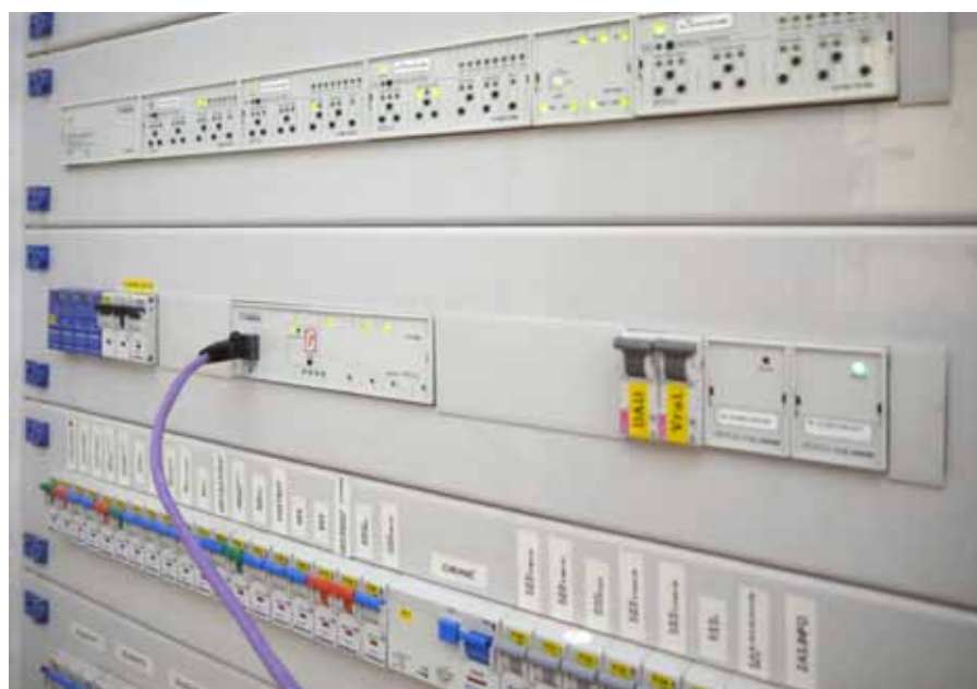
Obr. 4 Systém Foxtrot na síti LAN v rozvodnici společně s jističi; v horní řadě moduly ovládání žaluzií, v prostřední řadě v popředí řadiče dvou větví DALI, celkem pro 128 svítidel
