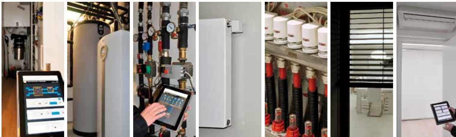
Větrání s rekuperací, kotel, tepelné čerpadlo, topné větve, radiátory, podlahové topení, žaluzie a klimatizaci má Foxtrot pod centrální kontrolou. Může tak optimalizovat a koordinovat jejich účinek na vnitřní klima v každé části budovy, v každé místnosti.
