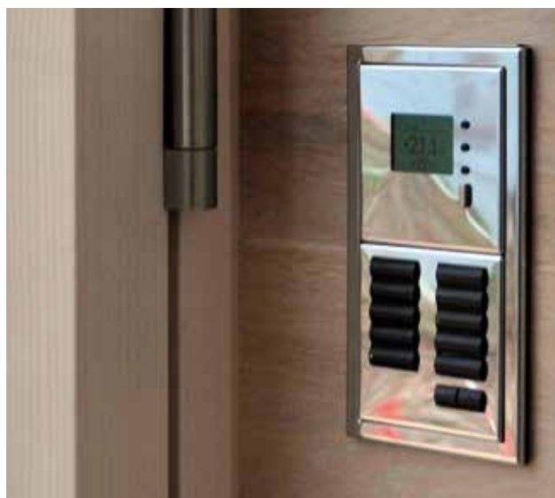
Nástěnná tlačítka, vypínače a termostaty zůstávají základem i u inteligentní instalace. Komunikují však s centrálou Foxtrotu a lze je ovládat i na dálku.
