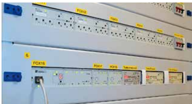
Řídicí systém Foxtrot a jeho ovládací moduly se instalují společně s jističi silových rozvodů, Foxtrot má spojení i se všemi senzory v domě a je zároveň webovým serverem celého domu.
