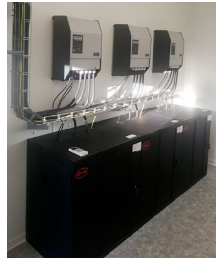
Obz. Instalace HFVE ve firmě AG Foil v Břeclavi je podobná. Je také třífázová s měniči Studer a bateriovým uložištěm BYD a Foxtrot tu řídí nadřazené funkce
